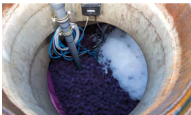
Die biologische Kläranlage funktioniert mit Sauerstoff und Trillionen nützlicher Bakterien.
