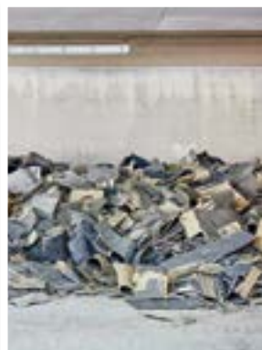
Links: Durch Chloride geschädigter Beton
