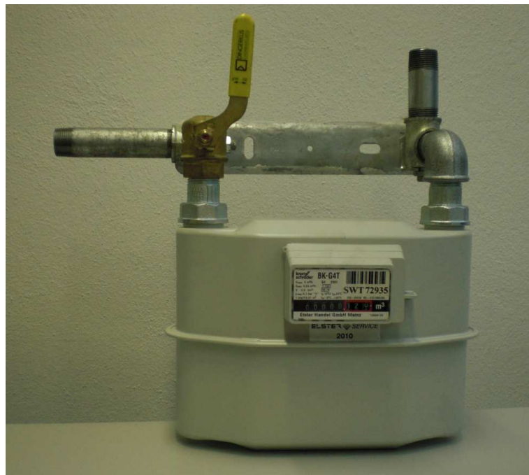
Abbildung 2: Zähleranschlussplatte mit Zweirohrbalgenzähler
