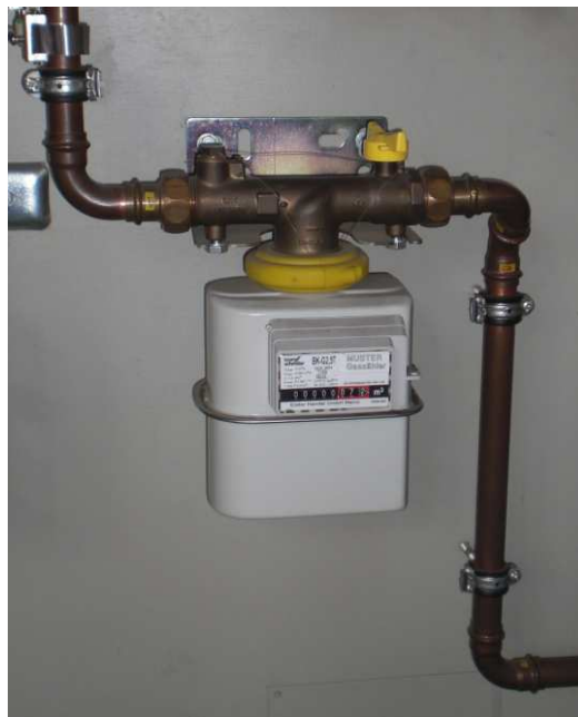
Abbildung 1: Zählerplatte mit Einrohrzähler
